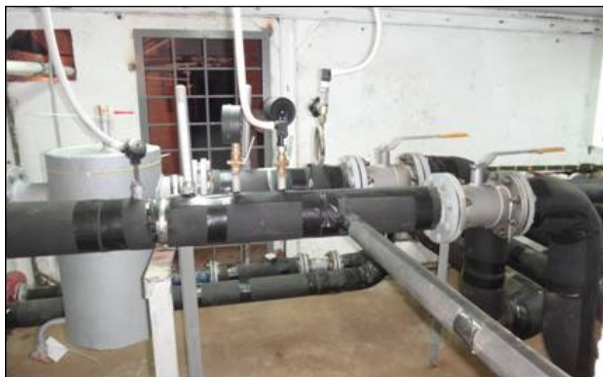
Рис. 2. ИТП, установленный в подвале жилого дома № 34 по ул. 7-я Подлесная
